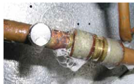
Gambar23 Air sabun berfungsi untuk mengetahui lokasi kebocoran [3].
